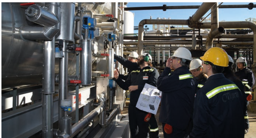
Instalación del prototipo en la instalada en la petroquímica Tüpras, en Izmit (Turquía).
