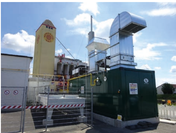
El cogenerador de hidrógeno Agenitor H2-CHP 406 SG de 2G se utiliza para convertir nuevamente en electricidad el hidrógeno, que se obtiene de la energía eólica con la ayuda de un electrolizador como parte del concepto PtG de Stadtwerke Haßfurt.
