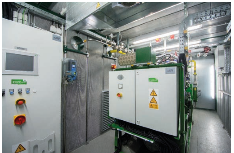
La solución en contenedor plug&play (lista para conectar) del Agenitor H2-CHP 406 SG de 2G tiene una potencia eléctrica de 140 kW. Fuente de la imagen: 2G Energy AG
